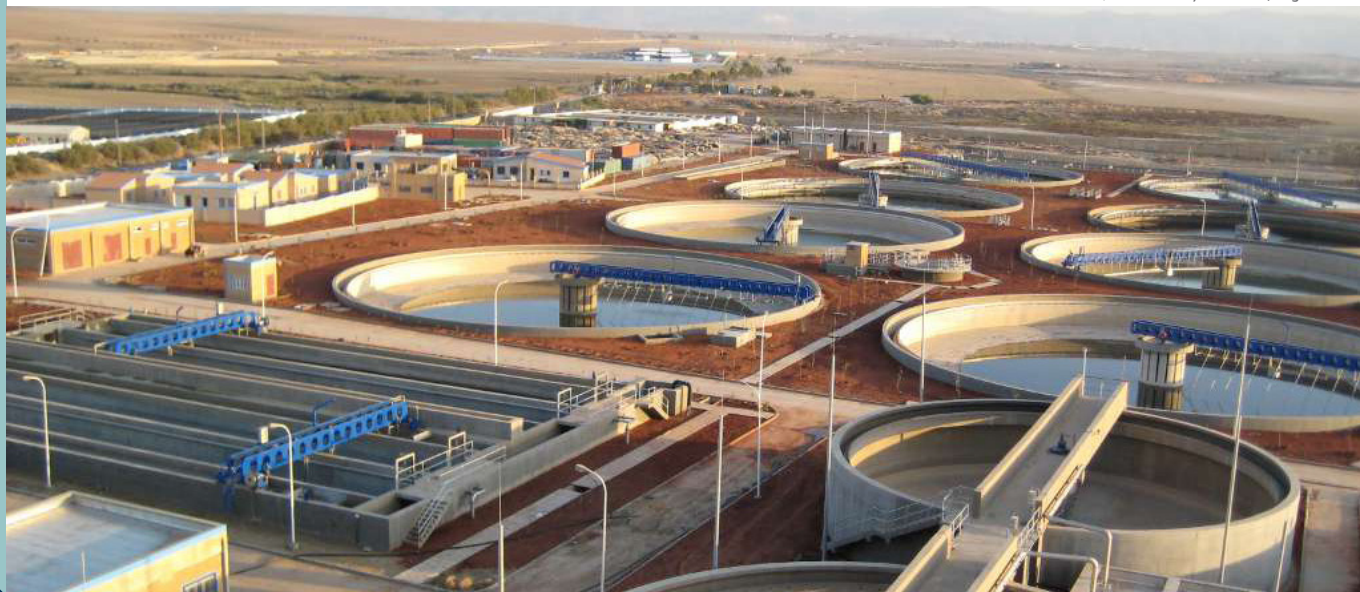
Construction d'une nouvelle station de traitement des eaux usées de 270 000 m 3 / jour. Oran, Algérie.
