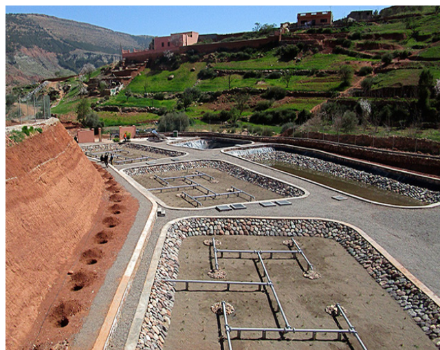
Le projet d'épuration des eaux usées à Asselda (Maroc) approvisionne les habitants et les vergers en eau propre.
